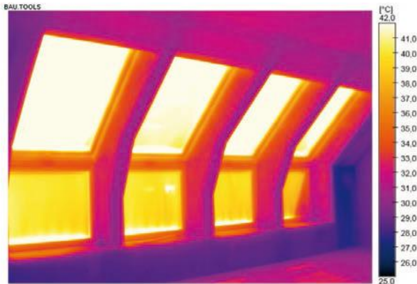
Thermogramm bei Unterdruck
