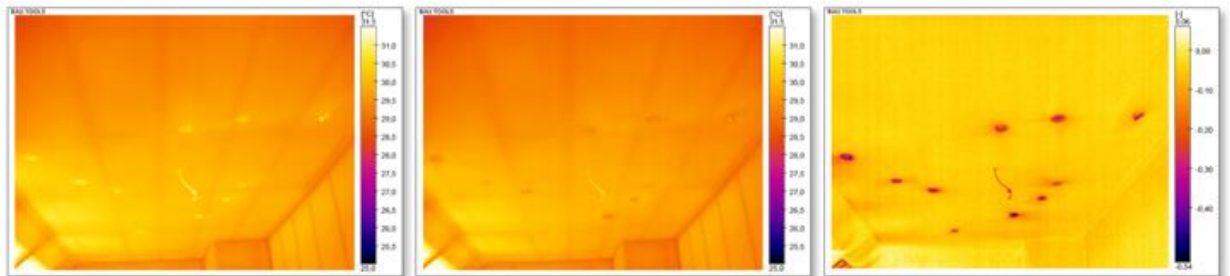
Leckagen an Einbau-Deckenstrahlern (Downlights)
